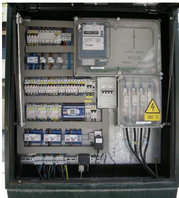
Centro de mando con protecciones, equipo de telegestión y módulo de la compañía. Fuente: AFEISA
